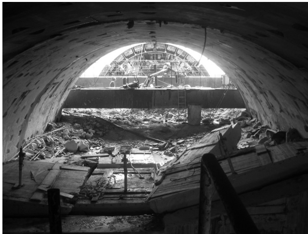
Figura 7 – Vista do interior da galeria para a Zona do eixo 1 a 4. Zona do “rolhão”
