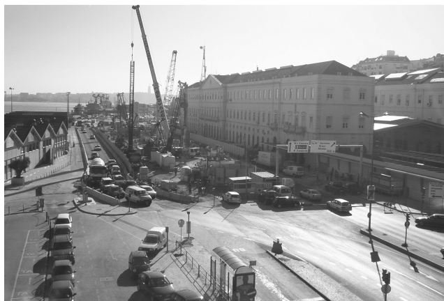
Figura 1 – vista da zona da obra – à esquerda Avenida e à direita a estação ferroviária da REFER
